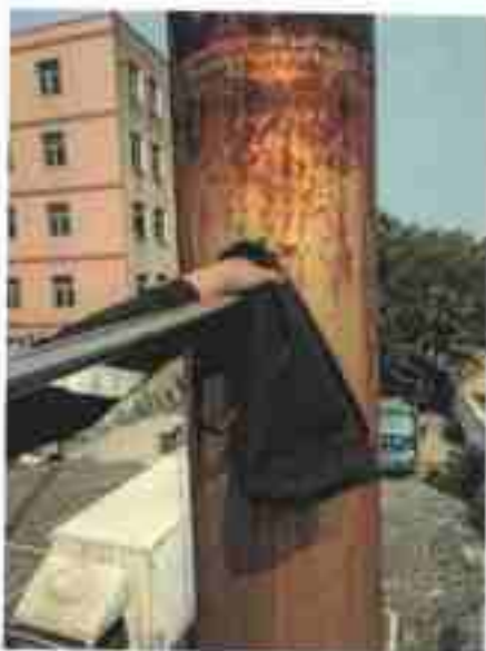
锅炉废气排气筒 A#
